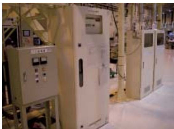
図1. 排気ガス処理装置の外観
