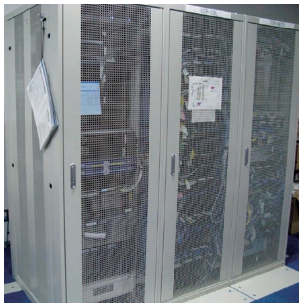
図1 新たに設置したネットワーク設備ラック。左から、計算機ラック、ケーブルラック、ネットワーク機器ラックの連結ラックを採用した。
