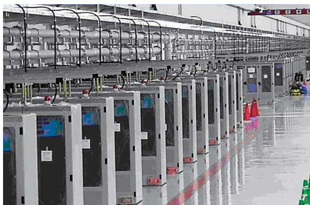
図7 XFEL加速器棟クライストロンギャラリーのタイミング・低電力高周波ラック機器の設置状況
