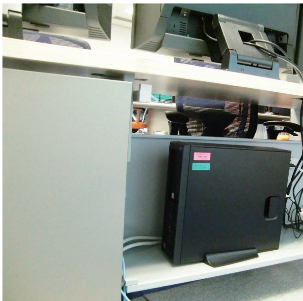
図7 中央制御室制御卓への端末計算機実装状態
